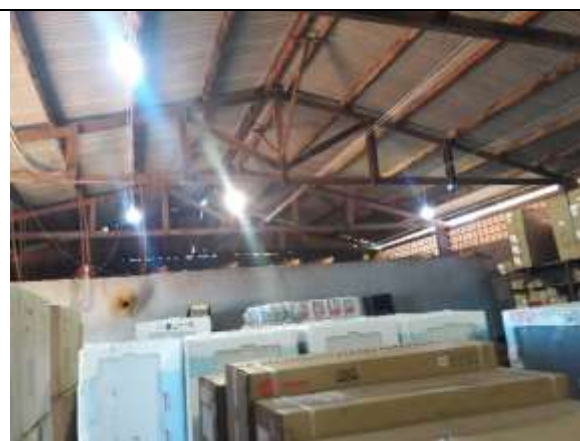
Imagem 2: Abertura no telhado e parede;
